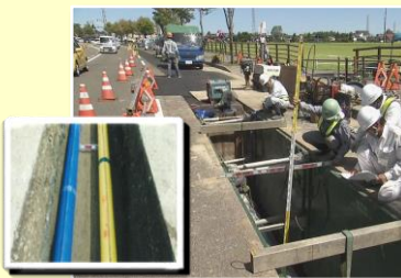
黄色：ガス用ポリエチレン管 青色：水道用ポリエチレン管
