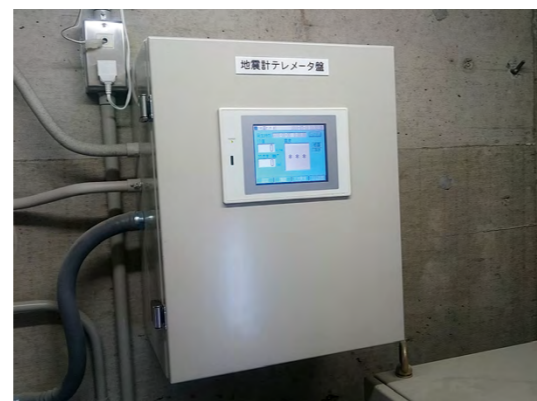
南本町整圧器室
