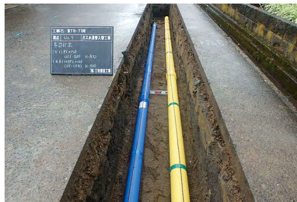
耐震管（左：水道管、右：ガス管）
