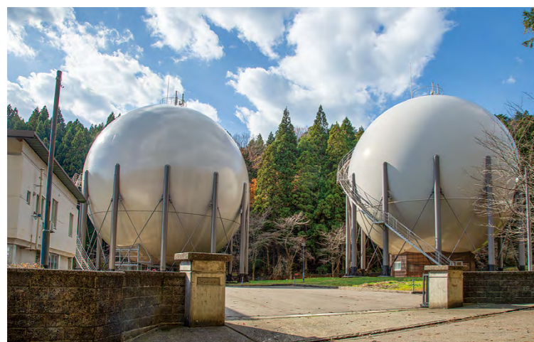
春日山ガス供給所
