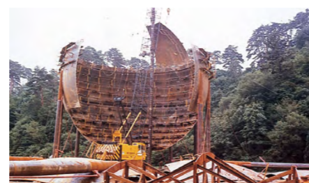
春日山ガス供給所 球形ガスホルダー建設中(昭和53年頃)
