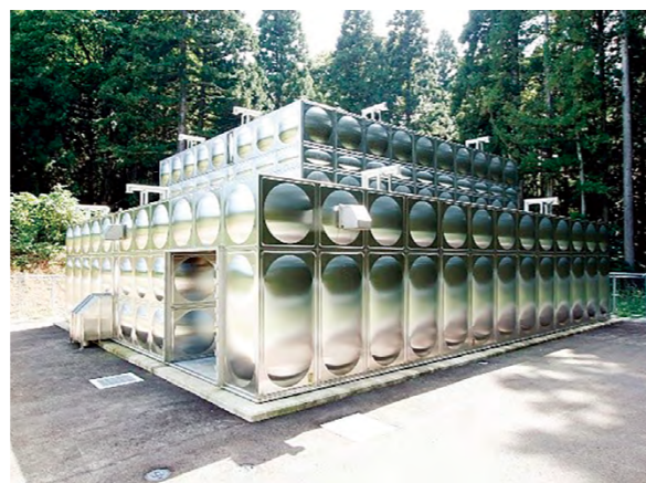
清里第3 配水池
