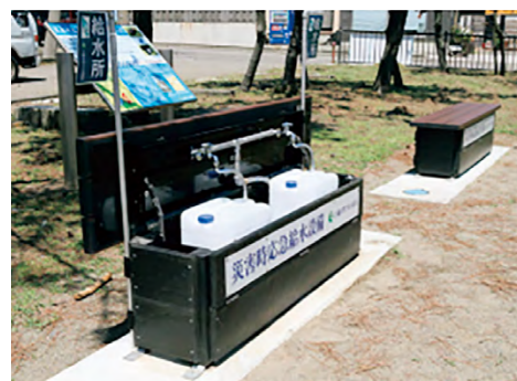
災害時の 応急給水設備
