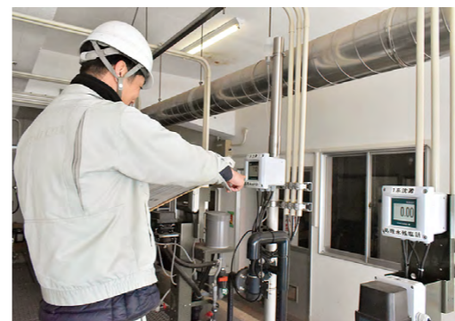
浄水工程の監視
