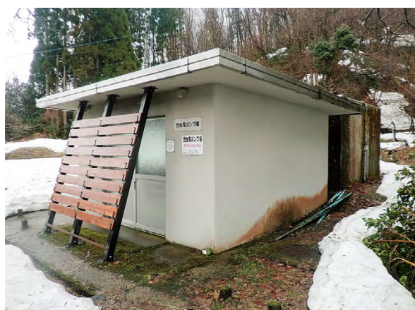
西吉尾ポンプ場
