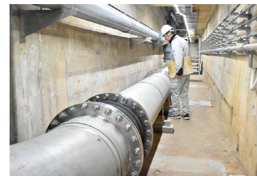
設備の安全点検
